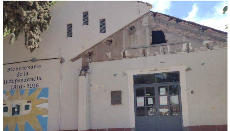
El 18 de enero de 2021 ocurrió un sismo de magnitud 6.4 en San Juan. A causa de ello, la escuela fue demolida debido a los graves daños generados. En marzo de 2022, comenzó la etapa de reconstrucción. Esto generó fuertes impactos en la percepción del sismo en los niños y niñas al verse dañado uno de los espacios donde pasan jornada completa.
